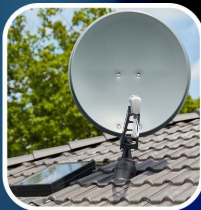
Sistemas VSAT y Energía solar
